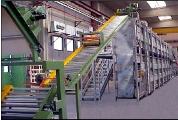
Linea di raffreddamento gomma a servizio estrusore
